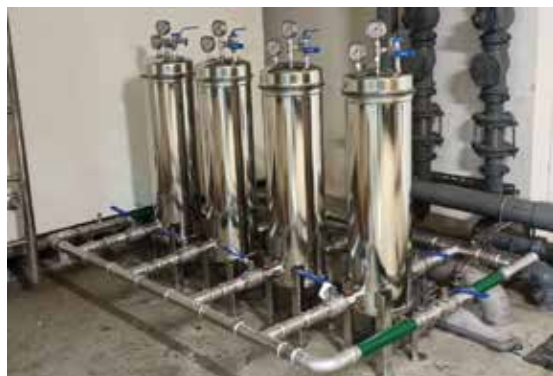
▲淨水設備安裝位置：總部地下四樓自來水箱旁
